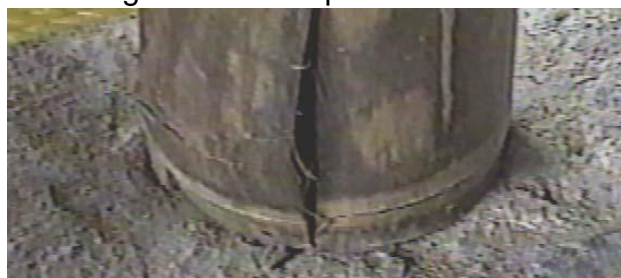
Figura: 2.21: Falla de guadua a compresión
