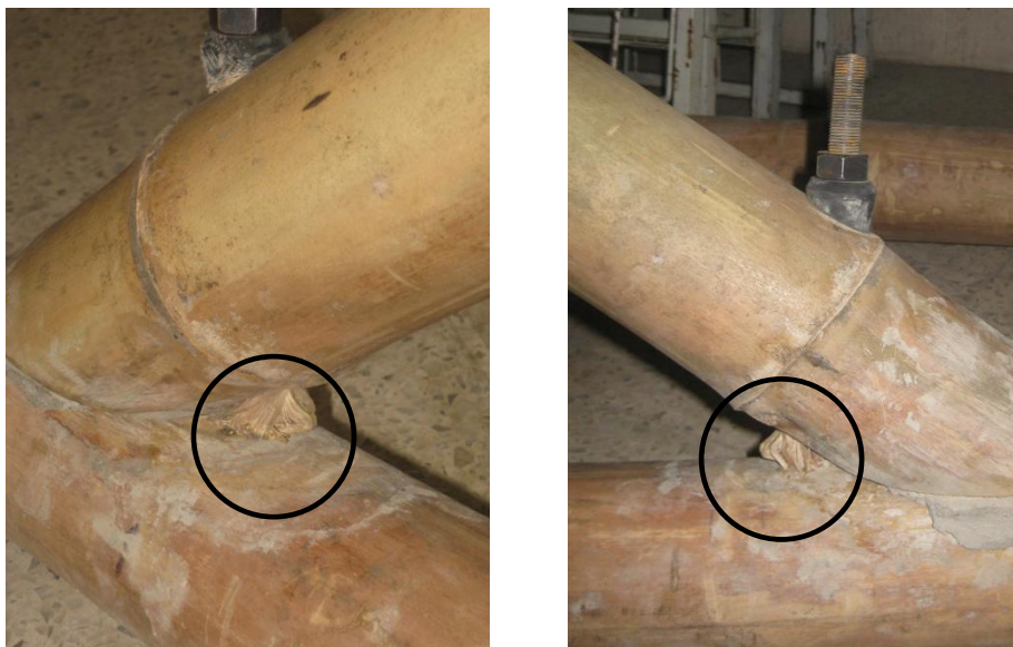
Figura 5.16: falla presentada en la junta CECM (conexiones empernadas con mortero)
