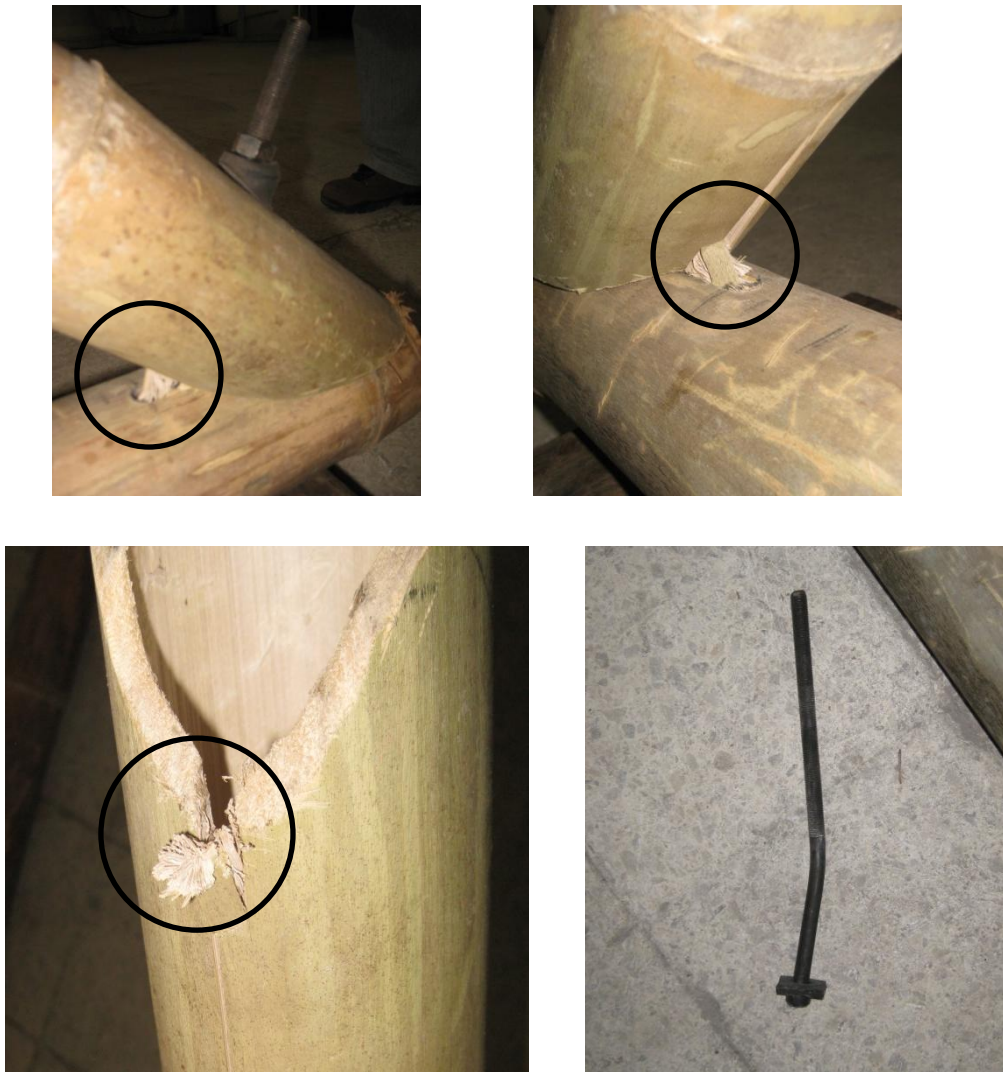
Figura 5.10: fallas por corte en el cordón superior de la cercha y flexión del perno
