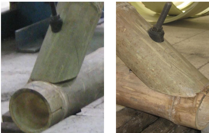
Figura 5.9: deslizamiento del cordón superior de la cercha
