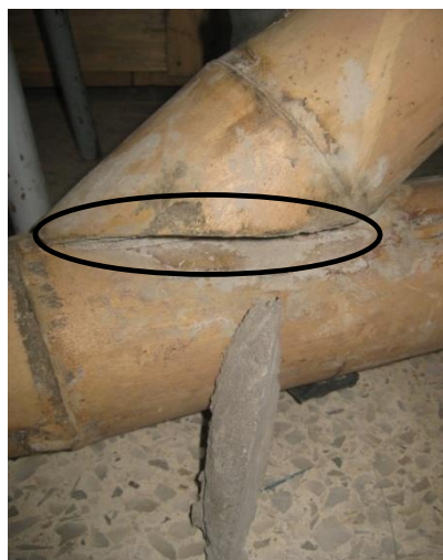
Figura 5.17: desprendimiento de mortero
