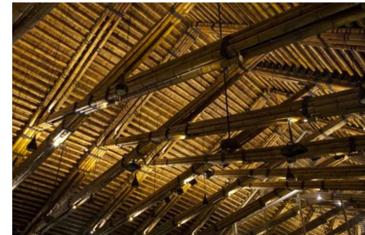
Fotografía 24 Estructura Cubierta Fuente: www.google.com
