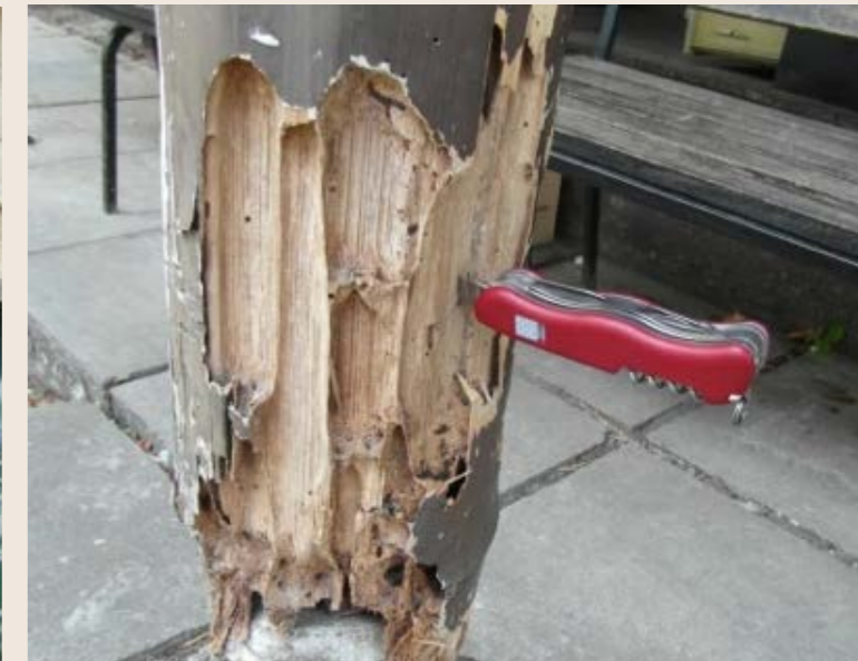
Figura 10: Daño severo causado por termitas en el bambú, Costa Rica
