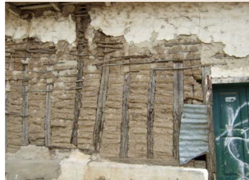
Figura 9: Daños severos a madera y caña en bahareque tradicional causados por termitas, El Salvador
