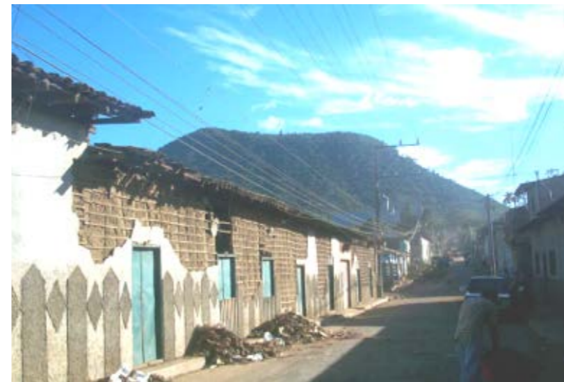
Figura 1: Vivienda tradicional en bahareque tras el terremoto de El Salvador 2001. El daño se limita al desconche del mortero, mientras que la estructura resiste intacta y segura.
