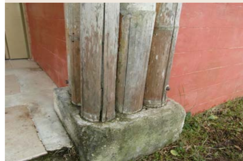
Figura 11: Daño por hongos, desarrollo de fisuras y blanqueamiento de bambú tratado con boro expuesto al sol y la lluvia después de alrededor de 10 años, Colombia
