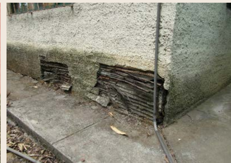
Figura 12: Pudrición del bambú en paredes, Costa Rica. Fijarse en el moho visible en la base de las paredes debido a salpicado de agua lluvia proveniente del techo
