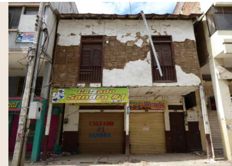
Figura 2: Vivienda tradicional en bahareque tras el terremoto de Ecuador 2016. El daño se limita principalmente al desconche del mortero, mientras que la estructura resiste intacta y segura.
